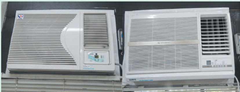
▲ 新購買並安裝於標本典藏室的二台冷氣機
